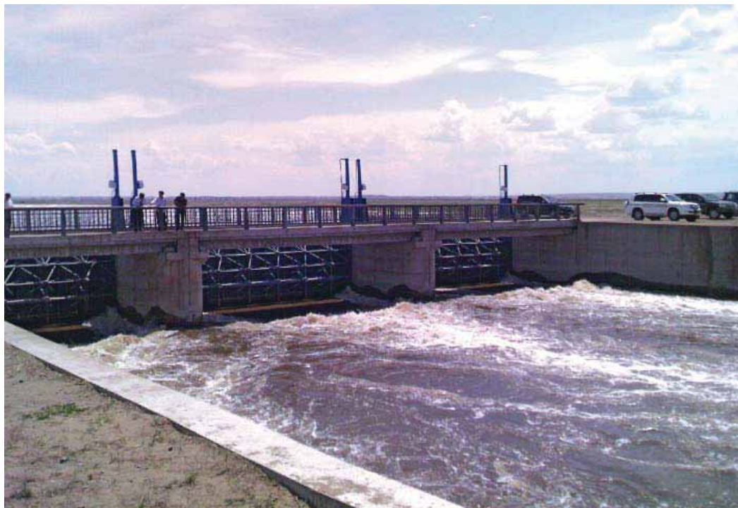
Рис. 7.16. Водозаборное сооружение канала у р. Хайлар 2011 г. Фото Е. Симонова
